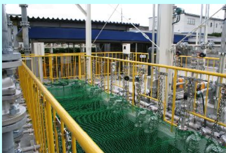
新排水処理設備
