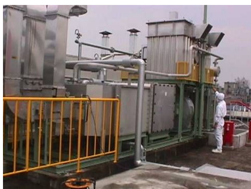
化学物質の排出削減対策 (溶剤回収装置)
